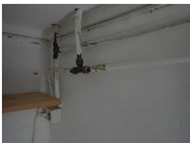
Vannrør i bod under bad
