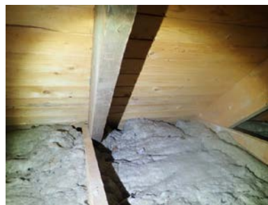
Ingen lufte-spalte av skråtaket
