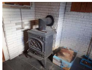
Ovn for fast brensel montert i kjellerrom.
