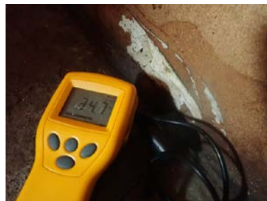
34,7% fuktighet i nedre del av veggplatene
