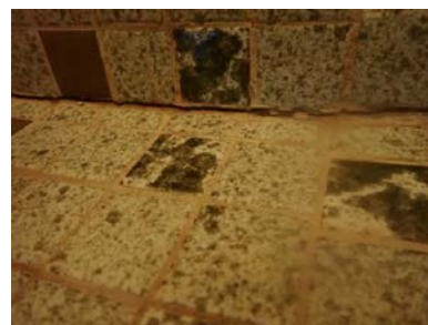
Sprekk mellom gulv og flisfot
