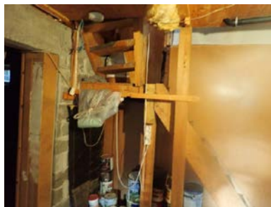
Bratt kjellertrapp uten rekkverk og håndlist
