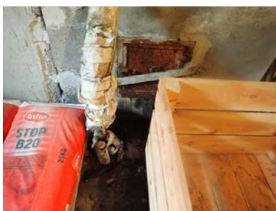
Stoppekran fra byggeår.
