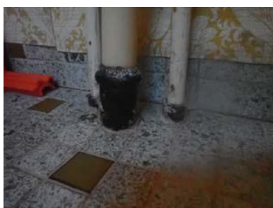
Ingen synlig membran ved rørgjennomføring i gulv.
