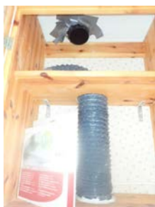
Avtrekk fra ventilatoren er frakoblet/ikke videreført over tak
