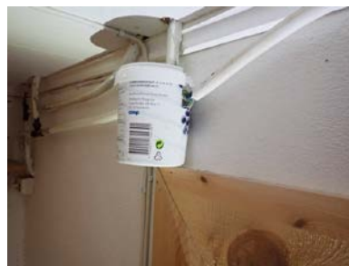
Vannrør i bod under bad. Her er det plassert en plast dunk for oppsamling av lekkasje vann.
