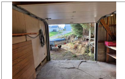
Stor sprekker i betonggulv.
