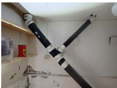
Plast avløp fra bad og kjøkken
