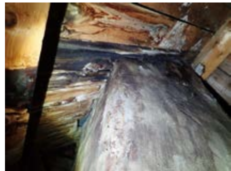
Fukt/råteskadet trobord ved pipegjennomføring
