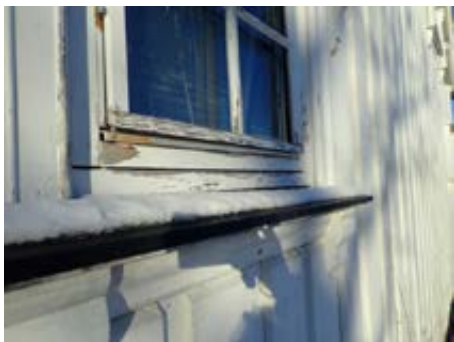
Værslitt Vindu på bad
