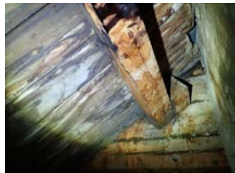
Fukt/råteskadet trobord ved pipegjennomføring
