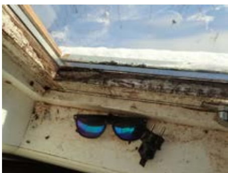
Råteskadet vindu på soverom
