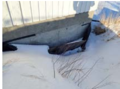
Del av grunnmursplastener løsnet fra grunnmuren
