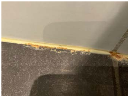
Missfarget og slitt silikonfuge
