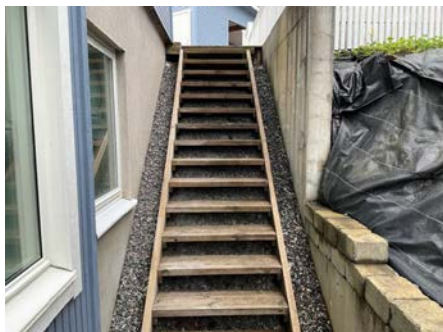
Trevirket er værslitt og det er tendenser til råde.
