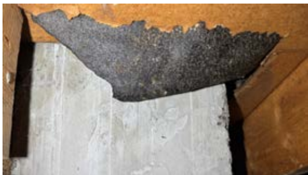
Underliggende tetting (under takpanner/pipebly) er ikke fagmessig utført. Bilde er tatt fra loft.
