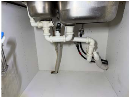
Røropplegg i kjøkkenbenk
