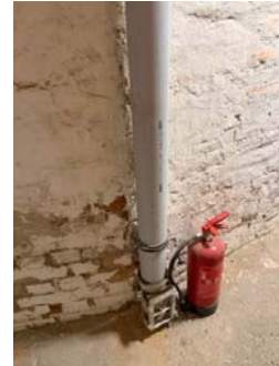
Plast avløpsrør med stakeluke
