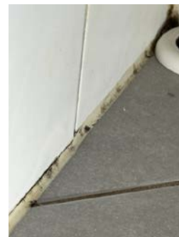
Svertesopp i silikonfuge nede ved gulv bak badekar
