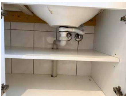
Røropplegg i servantskap
