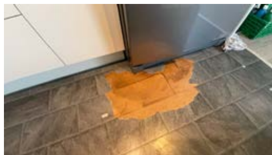
Fuktskade på kjøkkengulv.
