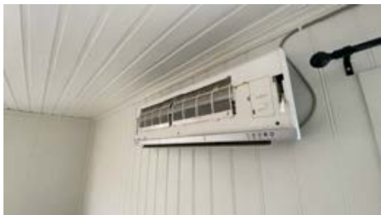
Innvendig luft til luft varmepumpe på stue
