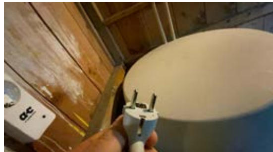
Ingen synlige brennmerker på stikk.
