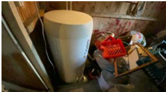
Varmtvannsbereder plassert i kjellerbod mot nordøst.
