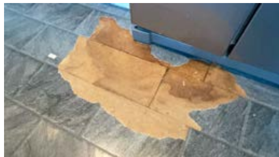
Vann/fuktskade ved kjøleskap på gulv mot kjeller.
