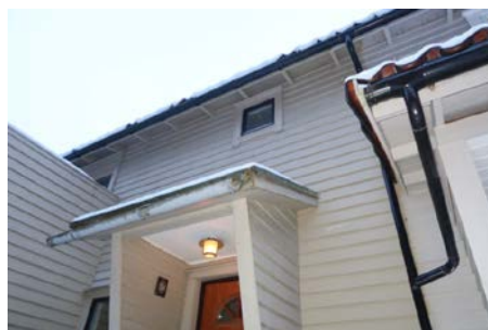
Slitt takrenne med åpne ender på takoverbygg ved ytterdør. Ikke nedløpsrør.
