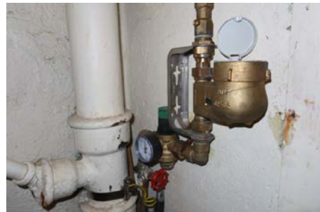
Stoppekran i kjeller.
