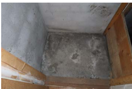
Fuktig gulv på grunn.
