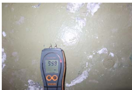
Fuktig i gulv på grunn bad kjeller.
