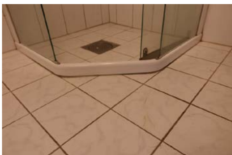
Tett bunnlist på dusjhjørnet
