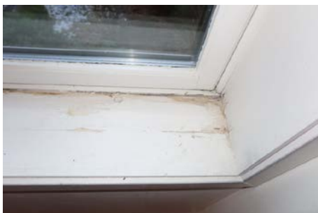
Stedvis slitte vindusforinger.
