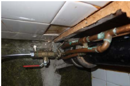
Irr på kobberrør.
