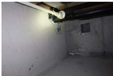
Tørt/ok. Kun litt saltutslag i ene hjørnet.
