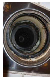
Ikke fagmessig utførelse tettesjikt i sluk (påforet løsning).
