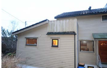
Balkong/terrasse ligger over innredede boligrom, usikker konstruksjon. Konstruksjonsutforming gir økt fare for skader.
