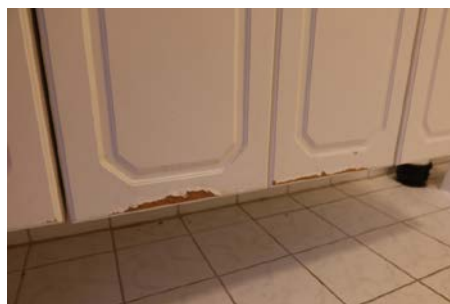
Slitasje på fronter servantinnredning.
