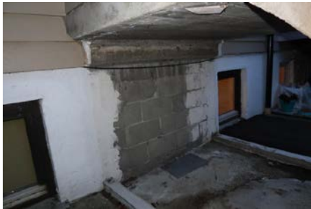
Grunnmur under trapp må pusses/males.
