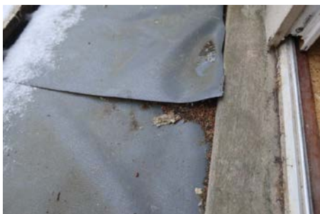
Løs pvc-duk på takterrasse nord (øverste laget med pvc-duk).
