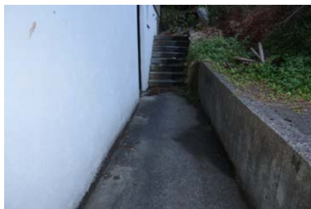
Manglende rekkverk på trapp og forstøtningsmur.
