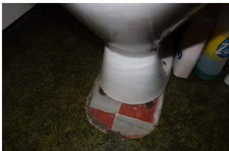
Ikke fagmessig utførelse tettesjikt.
