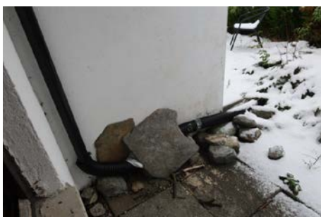
Det bør lages system for bortledning av vann fra taknedløp ved grunnmur
