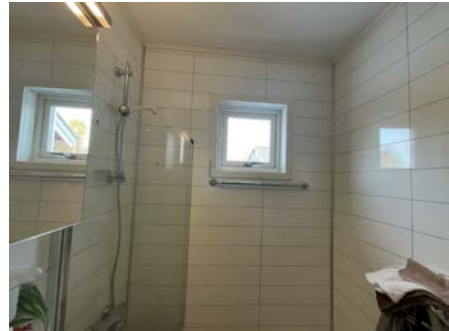
Vindu plassert i våtzone.
