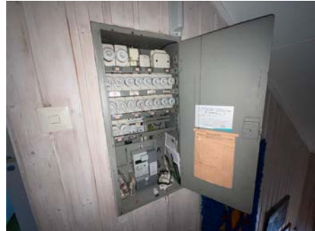
Sikringsskap plassert i loftet.
