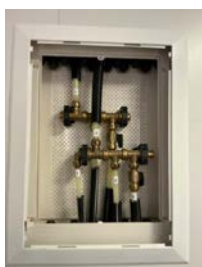
Vannrør med rør i rør-skap plassert i bad 2 etasje TG 1.
