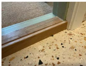
Eventuell opp-kant/membran ved terskel er skjult av terskel-list og er ikke tilgjengelig for kontroll.
