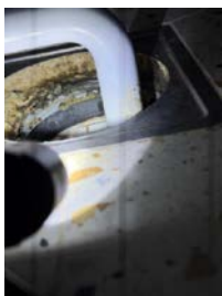
Sluk under badekar har begrenset tilkomst for kontroll.
