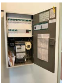
Sikringsskap står i gang 2 etasje.
