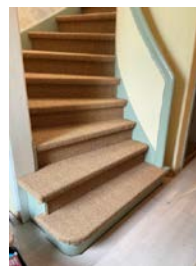
Rekkverk er ikke montert på nedre del av trapp.
