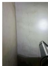
Riss/sprekker på puss på pipe i kjeller.
