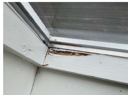
Tegn til kondensering på vindu innvendig.
