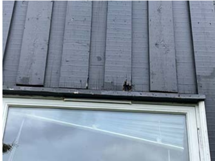
Råteskade i ett kledningsbord.
