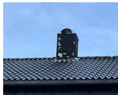
Avskalling i pipebeslag.
