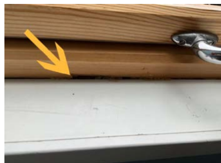
Foring er ufagmessig avsluttet og det er en lite skade i vinduet, slik at det åpningen mellom foring og vindu ikke er pen.
