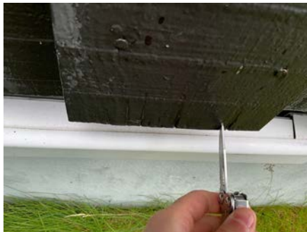
Mykt trevirke, som er ett tegn på råteskade.
