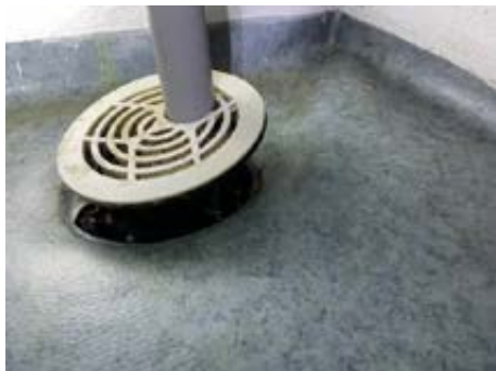
Belegg er løsnet på gulv ved sluk.
