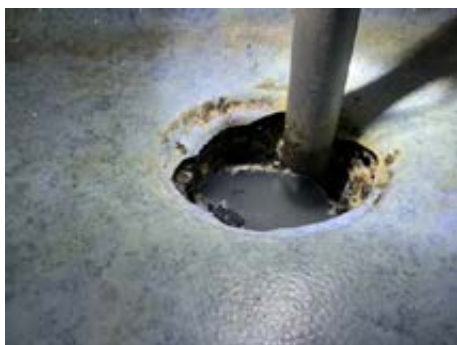
Klem-ring mellom belegg og sluk er ikke etablert og tetting er usikker.
