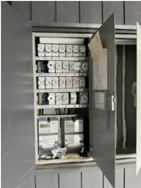
Sikringsskap står i felles svalgang.
