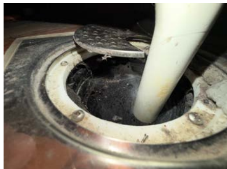
Sluk under dusjkabinett.
