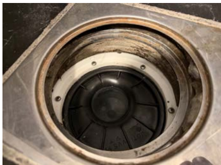
Sluk under dusjkabinett.
