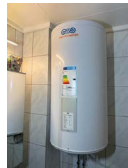
Bereder på baderomsvegg fra 2019
