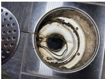
Sluk i dusjsone. (jordledning bør festes)
