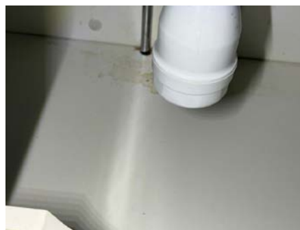
Røropplegg i servantskap
