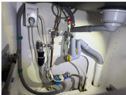
Røropplegg i kjøkkenbenk
