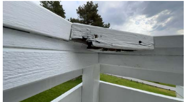
Råteskade på en trekloss.
