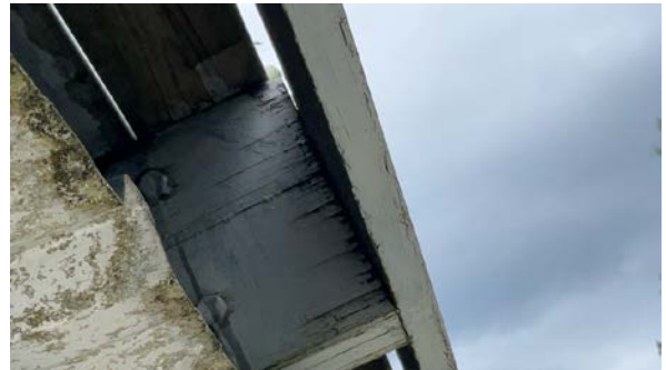
Værslitt og oppsprukket terrassebjelke.
