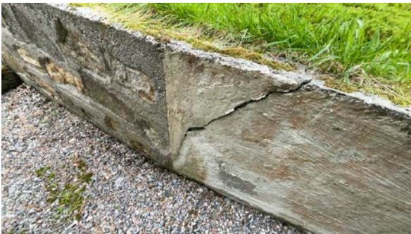
Sprekk i støttemur
