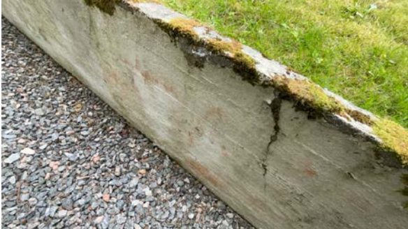
Sprekk i støttemur
