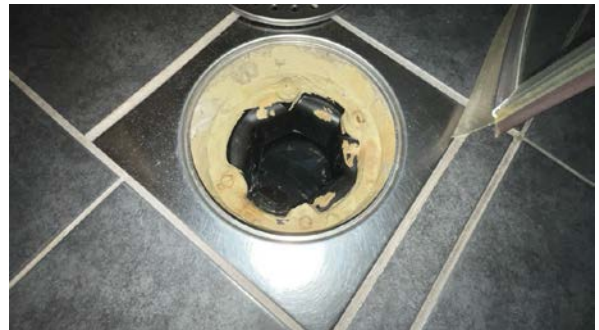
Sluk ved baderomsinnredning.
