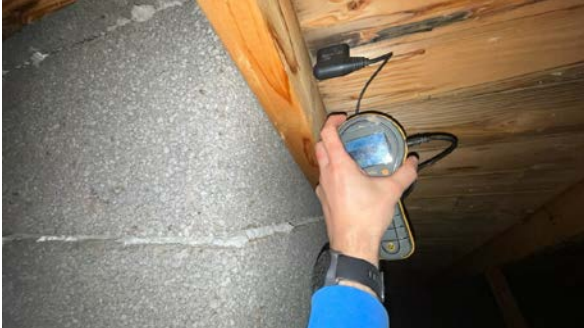
Målt etter fukt ved pipe. Dette gav utslag på fukt.
