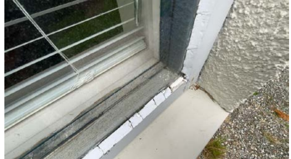
Vinduskitt er sprukket opp
