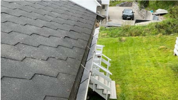
Vann stående i takrenne
