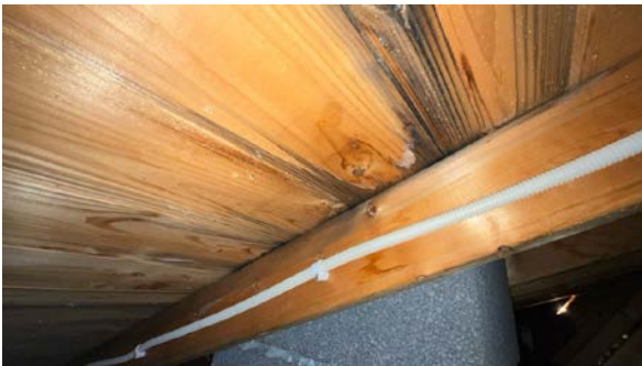
Fuktskjolde ved pipen. Det er flere fuktskjolder på loftet.
