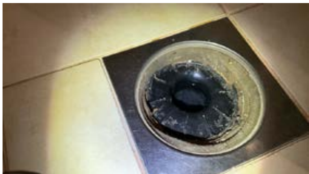
Sluk i dusjsonen
