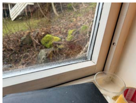
Vindu med innvendig kondensering.
