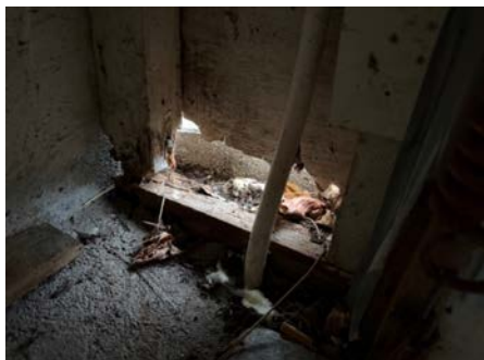
Råte i vegg i garasje
