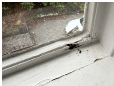
Vindu med gjennomgående råteskade.
