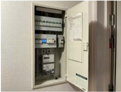
Sikringskap står i felles gang.
