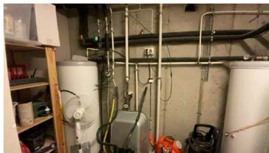
Felles anlegg i kjeller
