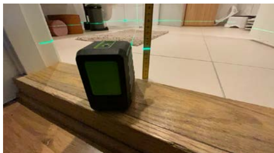
Høydeforskjell (flis ved terskel)
