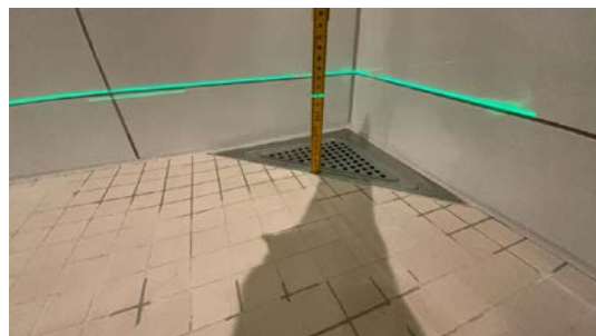
Høydeforskjell (ved sluk)
