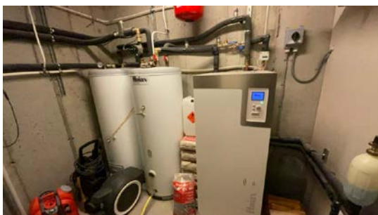
Felles anlegg i kjeller
