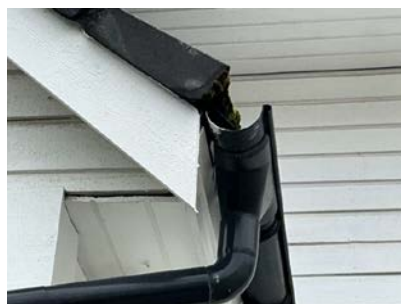
Ende-stykke mangler på takrenne ved inngang.
