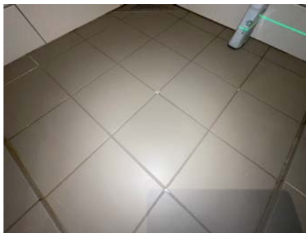
Synlige fliskryss i dusjsone. Bør refuges.
