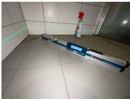
Det er avvik på lokalfall i dusjsone.
