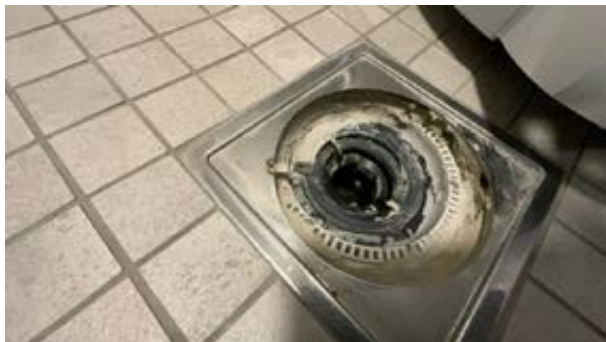
Sluk på vaskerom. Det er fuget på innsiden av klemringen.
