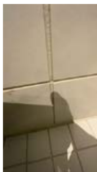
Det er observert riss i fuger flere steder.
