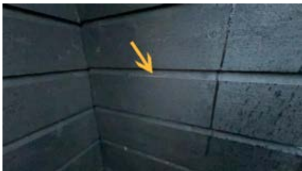
Tendenser til værslitt levegg.
