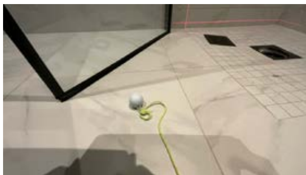
Hulrom under flis.
