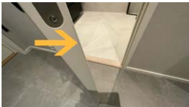
Lamineringen har sprukket.
