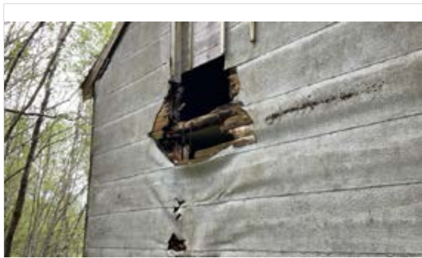
Bilde 3: Råteskader gavlvegg mot vest (som bilde 2)
