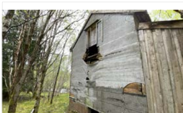
Bilde 2: Råteskader gavlvegg mot vest.
