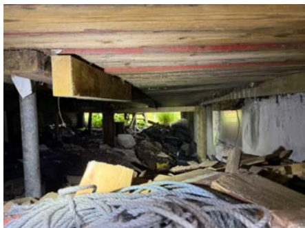
En del nedbøyning i gulvbjelke.
