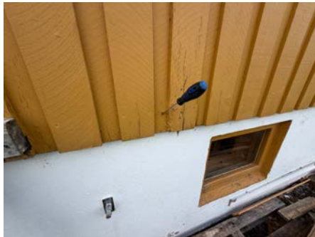
Råteskadet bordkledning, omfanget er fr
