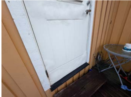
Fukskadet ytterdør inn til soverom.
