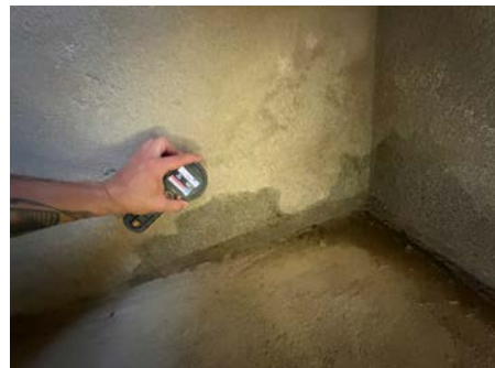
Fuktsøkt i nedkant av grunnmur. Utslag på fukt.
