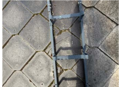
Det er påvist en del knekte taksteiner ved takstige.
