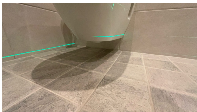
Lekkasjespalte på innebygget systerne bør opparbeides.
