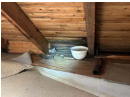
Spor etter fukt i undertak.
