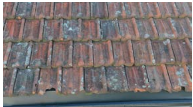
Forvitring i takstein.
