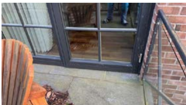
Oppbrett opp under balkongdørens terskel er for lav.
