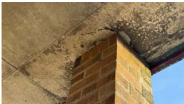
Sprekk i dekke anses stabilt.
