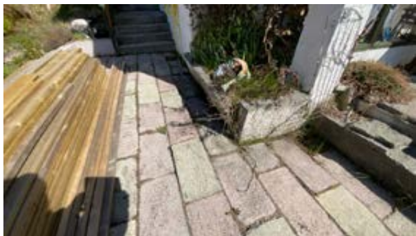
Skader sprekker på heller mm..
