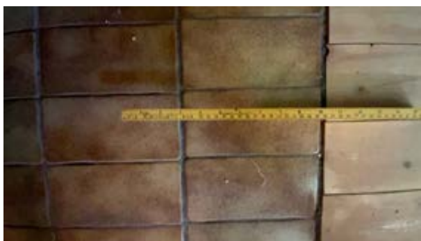
Ikke tilstrekkelig avstand på 300 mm. i front av vedovn i kjeller.
