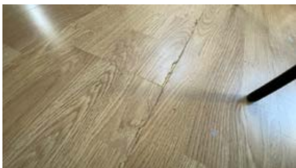
Skader i gulv.
