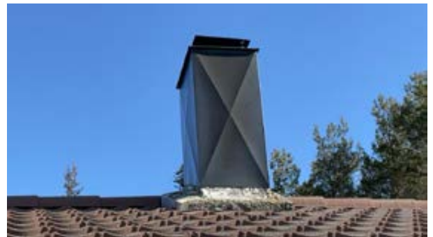
Manglende takfotbeslag på pipe.
