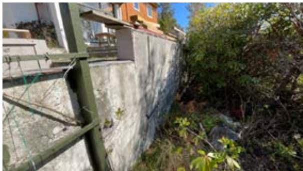
Forstøtningsmur mot syd uten sikring, skjev grunnet jordtrykk.
