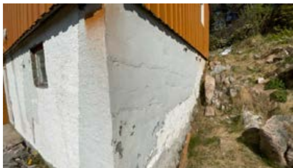
Tegn på utbedringer av ukjent årsak.
