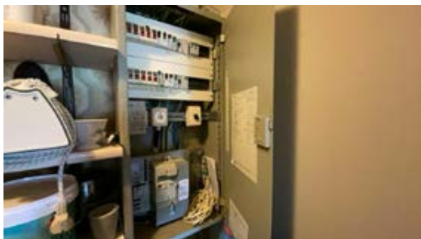
El. skap, med manglende tildekning mellom sikringene.
