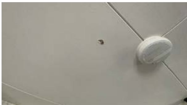
Skader i takplater.
