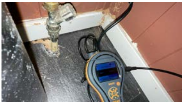
Piggmåling viste under 7 vekt%.
