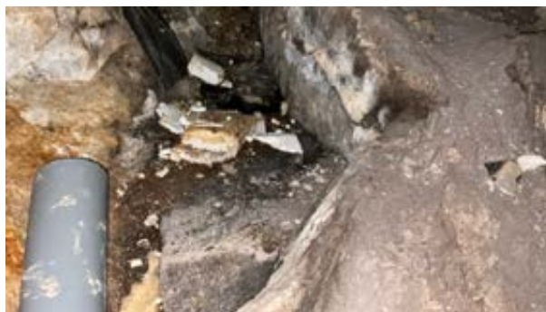
Synlig fuktinntrengning i krypkjeller langs grunnfjellet.
