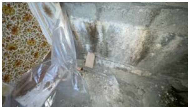
Visuelle tegn på fuktvandring ved salt/kalkutslag på yttervegg mot grunn
