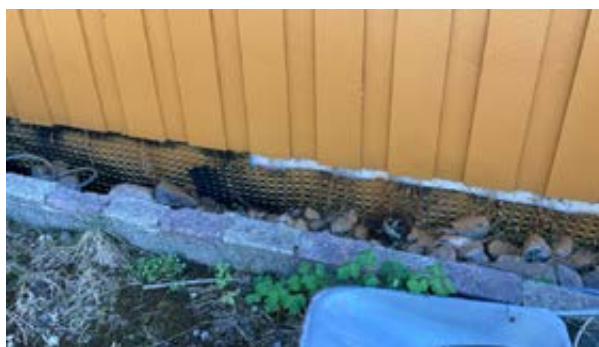
Manglende toppliste på grunnmur.
