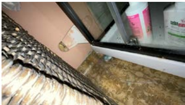
Åpent inn i bindingsverk i våtsonen.
