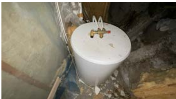
Varmtvannsbereder i krypkjeller.
