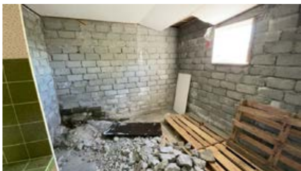
Vannskade i soverom sokkeletasje.
