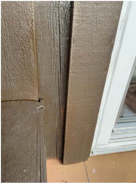
Sprekker i noen klednings-bord.
