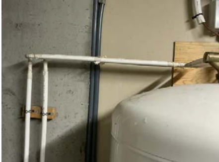
Vannrør er tapet over i skjøter.
