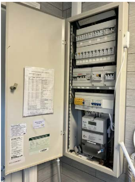
Sikringskap står i bi-inngang/vaskerom.
