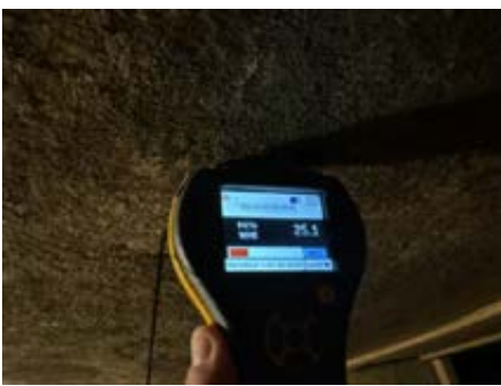
Forhøyede fuktverdier ble registrert.
