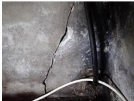
Sprekk i grunnmuren
