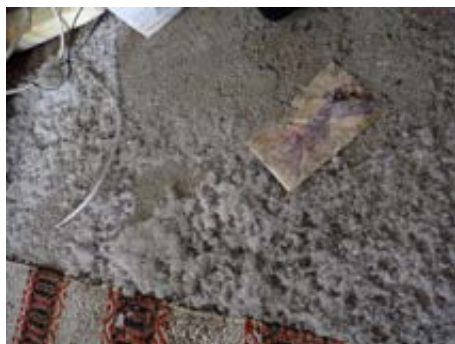
Saltutslag/muggsopp på gulv i trapperom.
