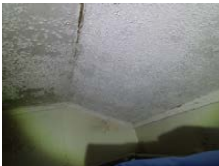
Store fuktskader i takplatene
