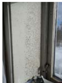
Muggsopp på foring på kjellervindu
