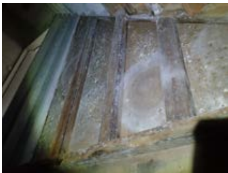
Muggsopp på vegg i trapp nedgang.
