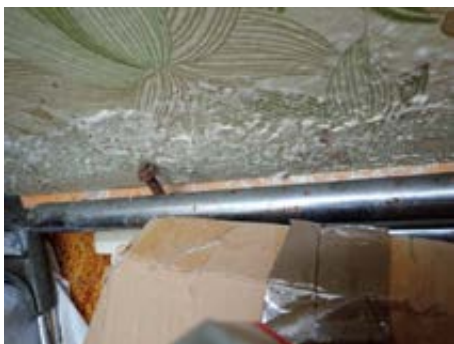
Muggsopp på vegg
