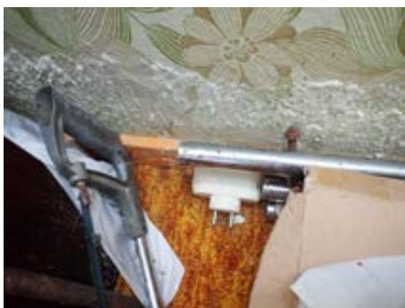
Muggsopp på vegg
