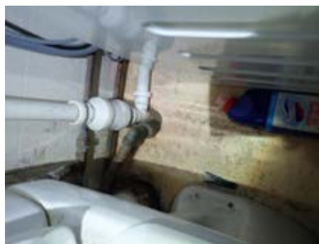
Mangelfull tetting rundt vann og avløpsrør. Gjelder også rundt avløp fra wc
