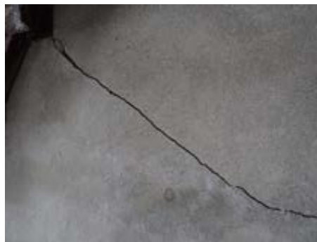
Sprekk i grunnmuren
