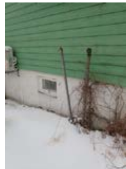
Påfyllingsrør og lufterør fra oljetank
