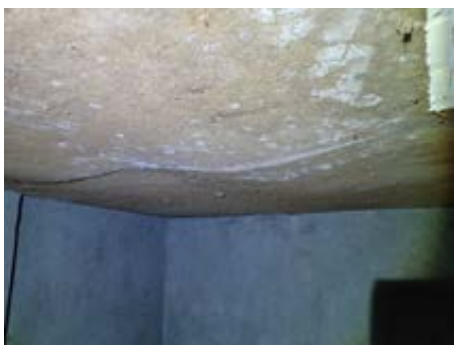
Muggsopp i tak i trapperommet
