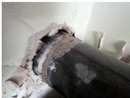
Manglende etablering av røykrør og malingsavskalling
