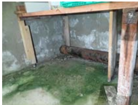
Råteskader i plassbygget benk
