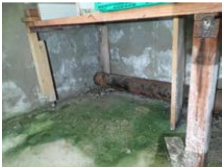
Muggsopp i gulv.
