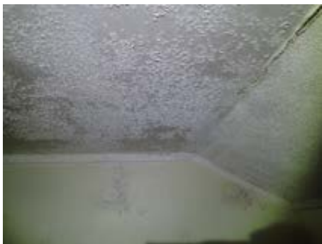
Fuktskader i tak
