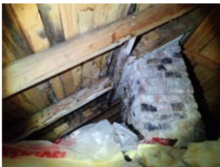
Fukt og råteskader i konstruksjon og trobord
