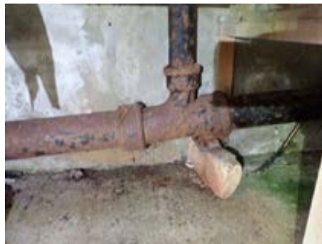
Rust i avløpsrør
