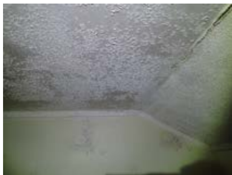
Store fuktskader i takplatene
