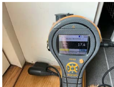
Fukt-merker på dør til underetasje. Ved fukt-søk er det registrert forhøyede verdier.
