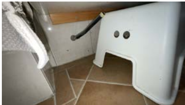
Avløpsrøret fra vannfordelerskapet ser ut til å ligge høyere enn vannfordelerskapet.
