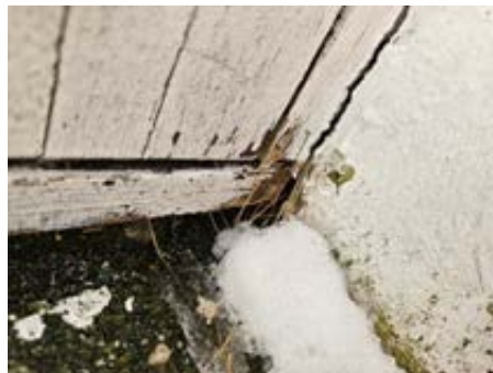
Døren har råteskade utvendig.
