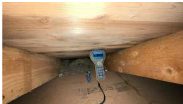
Det ble foretatt stikkkontroll ut mot raft og her ble det målt forhøyede fuktverdier.
