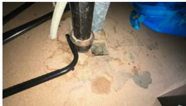
Fuktskjolde på gulvet i område rundt en takhatt.
