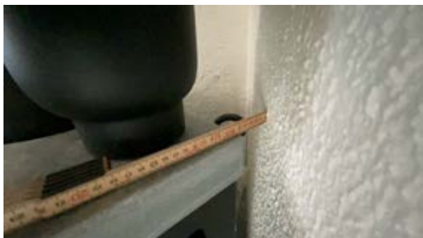
Ildstedet er plassert nærme brannmur.
