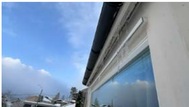
Istapper og råteskadet trevirke.
