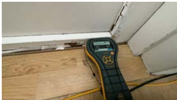
Døren er fuktpåvirket innvendig
