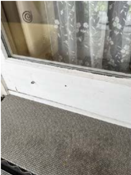
Terrassedør har endel slittasje
