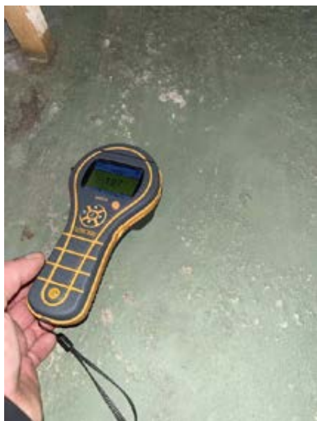
Noe forhøyede fuktverdier i kjellergulv
