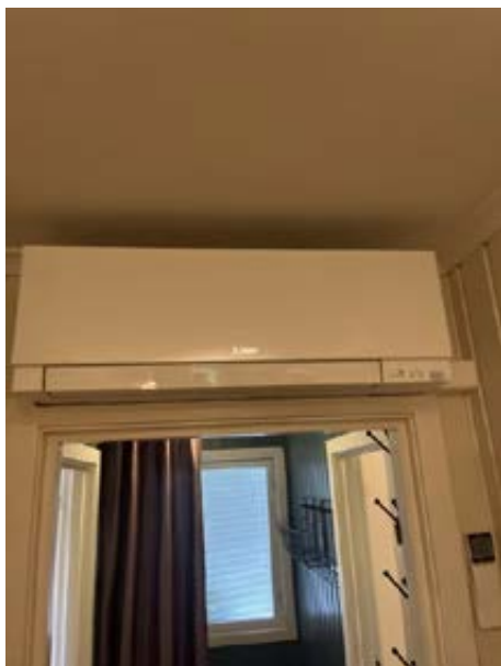
Varmepumpe i soveromsgdel
