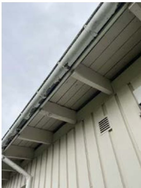
Renner har skader og avflassing flere steder og har behov for utskifting
