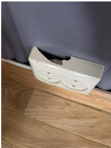
Sprekk i kontakt
