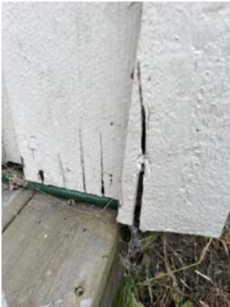
Råteskade registrert i kledning flere steder
