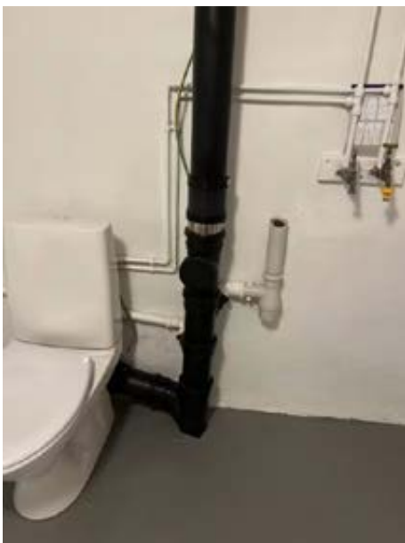
Stakeluke på avløpsrør i plast
