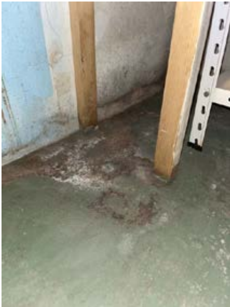
Fuktmerker og saltutslag enkelte steder i kjeller
