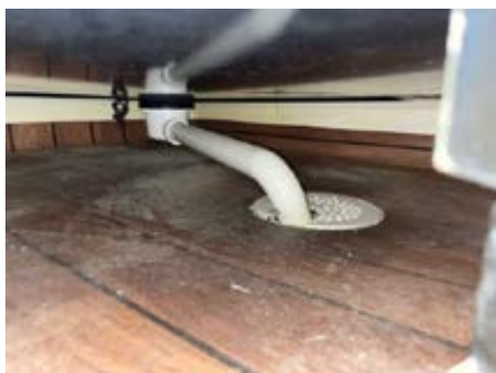
Sluk lokalisert under dusjkabinett
