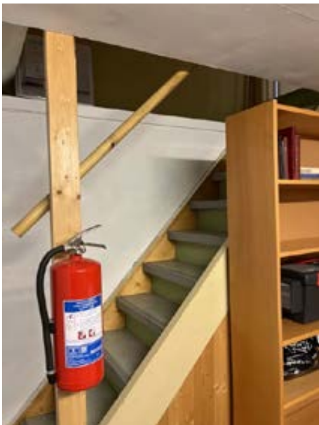
Manglende rekkverk. Nevnte forhold gis tilstandsgard 3
