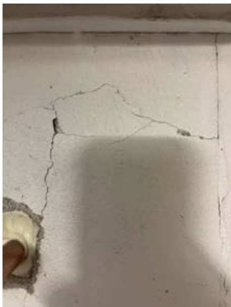
Mindre riss/sprekker registrert i grunnmur
