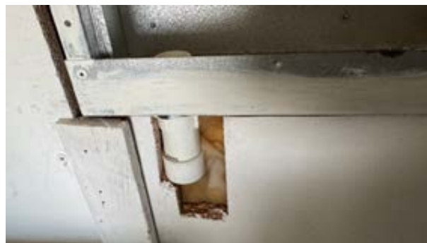
Drensutkast er ikke ført til vanntett gulv med sluk
