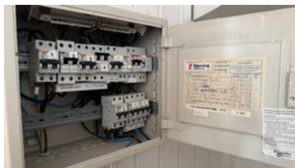
Det er ikke deksler rundt sikringene.
