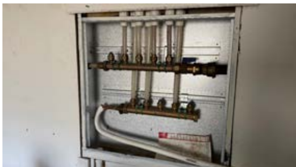
Rør i rørskap er ukomplett
