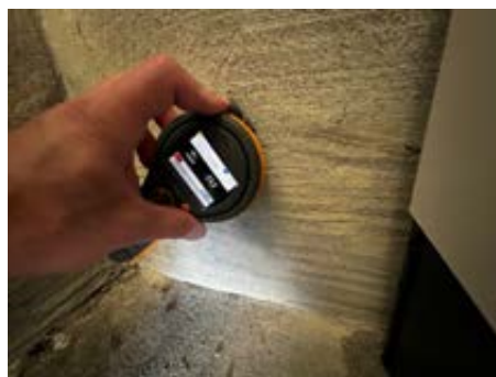
Fuktsøk på grunnmur i garasje som ligget mot terreng. Ikke utslag på fukt i øvre del. Ned mot gulv og midt på veggen gir det utslag på fukt.
