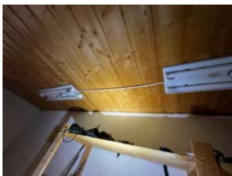
Løse ledning, TG3 i henhold til krav i NS 3600.
