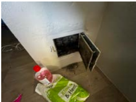
Mangler ubrennbar plate på gulv og vegg ved sotluken.
