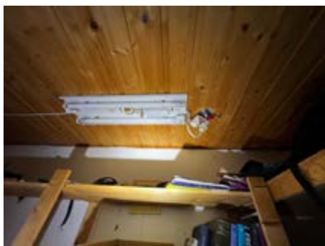
Løse ledning og koblingsbo, TG3 i henhold til krav i NS 3600.
