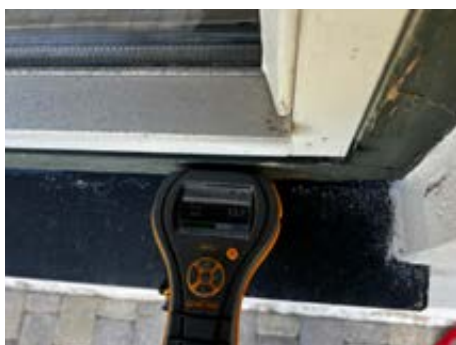
Normale fuktverdier i dette vinduet.
