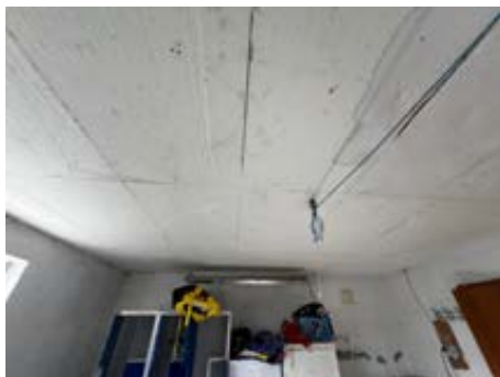
Åpen isopor i garasjetak.
