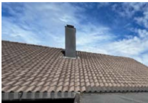
Det er ikke montert takstige til skorstein.
