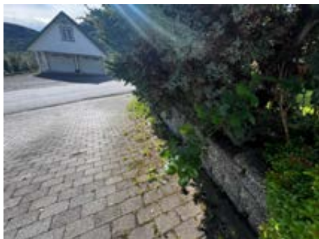
Større skjevheter i forstøtningsmuren ved innkjørsel etter marpress fra grunnen.
