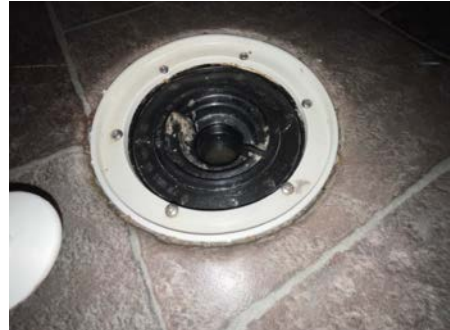
Sluk under dusjkabinett.
