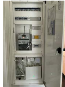
Sikringskap står i entre 1 etasje
