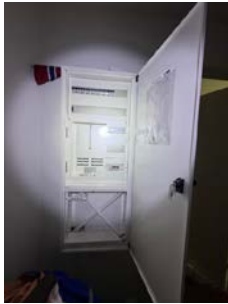
Sikringskap står i bod/vaskerom underetasje.
