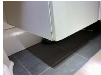
Noe svelling på baderomsinnredning
