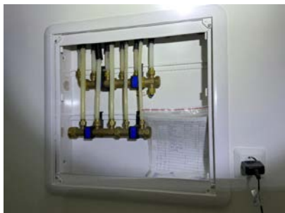
Rør i rør skap i underetasje.
