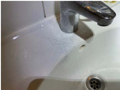
Riss i emalje på servant.
