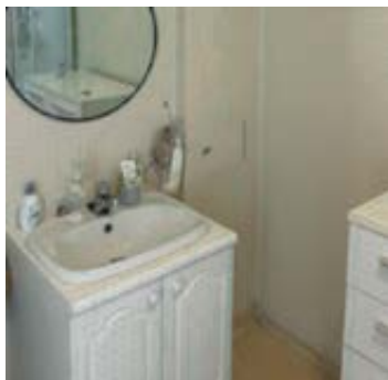
sotluke på bad i kjellerleilighet.
