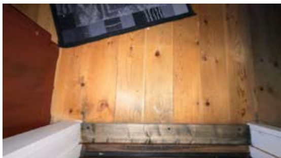
Misfarget gulv ved døråpning
