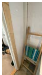
Ikke fagmessig utførelse av baderomsplate.
