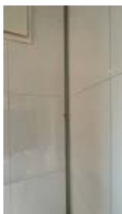
Ikke fagmessig utførelse av baderomsplate.
