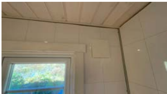
spjeldventil på yttervegg.
