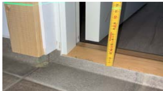
Høyde oppbrett gulvbelegg. 23mm over sluk.
