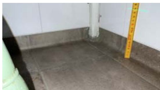
Ikke fagmessig utførelse av oppbrett på gulvbelegg.
