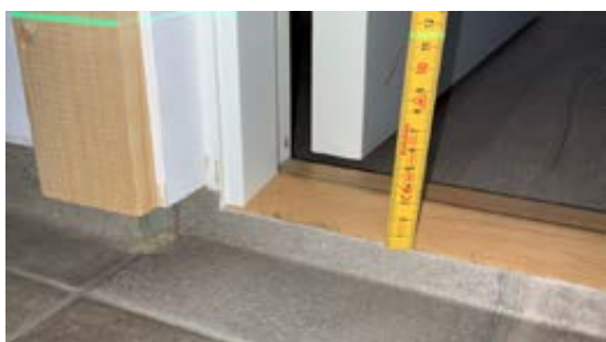
Ikke fagmessig utførelse av oppbrett på gulvbelegg.
