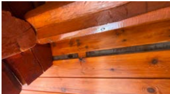
Skadet insektsnetting i raftekaske.
