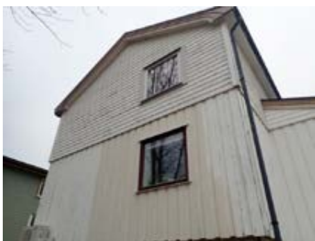
Værslitt kledning. Bør overflatebehandles.
