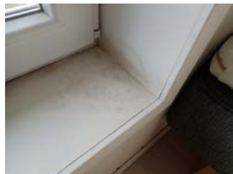
Fuktskader i foring
