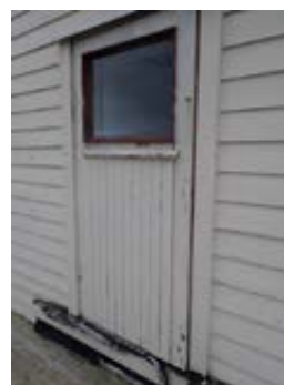
Trekkfull og råteskadet altandør må byttes.
