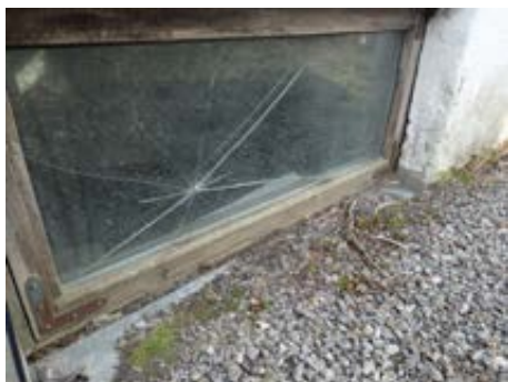
Kjellervindu med knust glass
