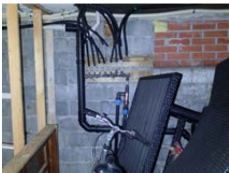
Rør i rør på vegg
