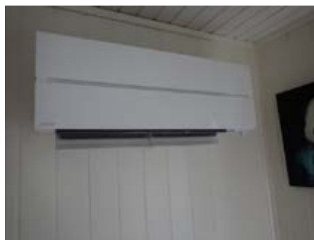
Varmepumpe luft til luft
