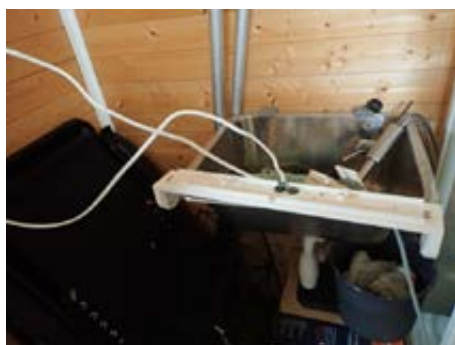
Løs taklys armatur med ledninger på vaskerom.
