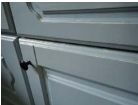
Slitasje på innredning
