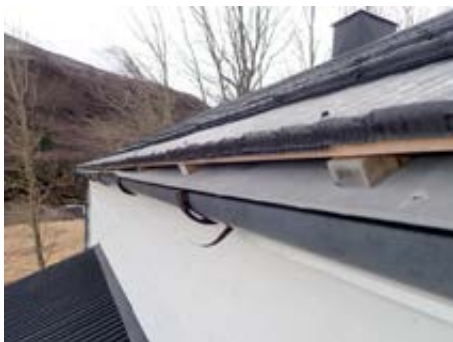
Mangler spillblikk Rustet takrennekroker.
