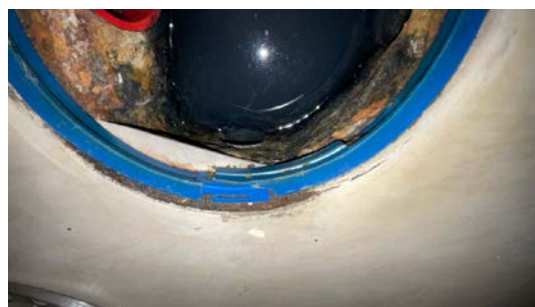
Sprekk i belegg
