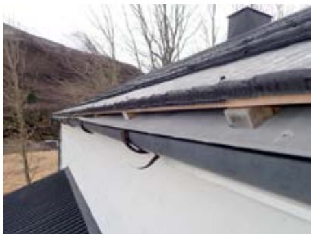
Mangler spillblikk Rustet takrennekroker.
