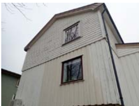
Værslitt kledning. Bør overflatebehandles.
