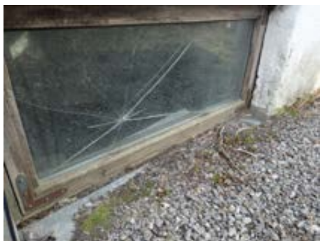
Kjellervindu med knust glass
