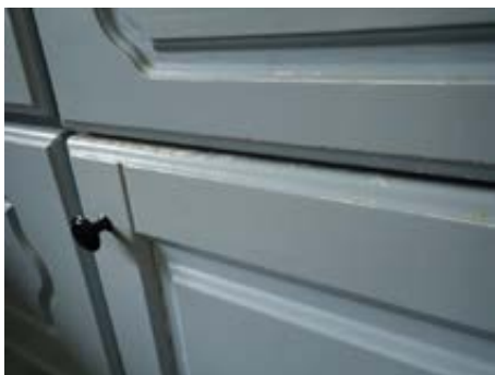
Slitasje på innredning
