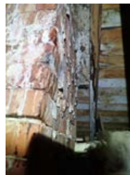
Fuktmerker i taktoa og sperre ved pipegjennomføring.
