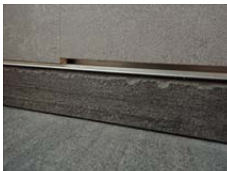
Store avvik - åpning mellom aluminiumsflit og veggplate.
