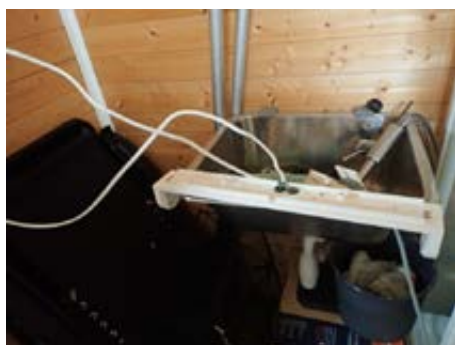
Løs taklys armatur med ledninger på vaskerom.
