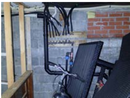
Rør i rør på vegg
