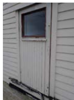
Trekkfull og råteskadet altandør må byttes.
