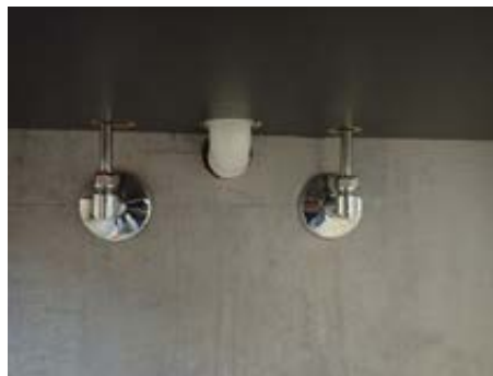
Vann/avløp til/fra servant. Åpent hull i vegg
