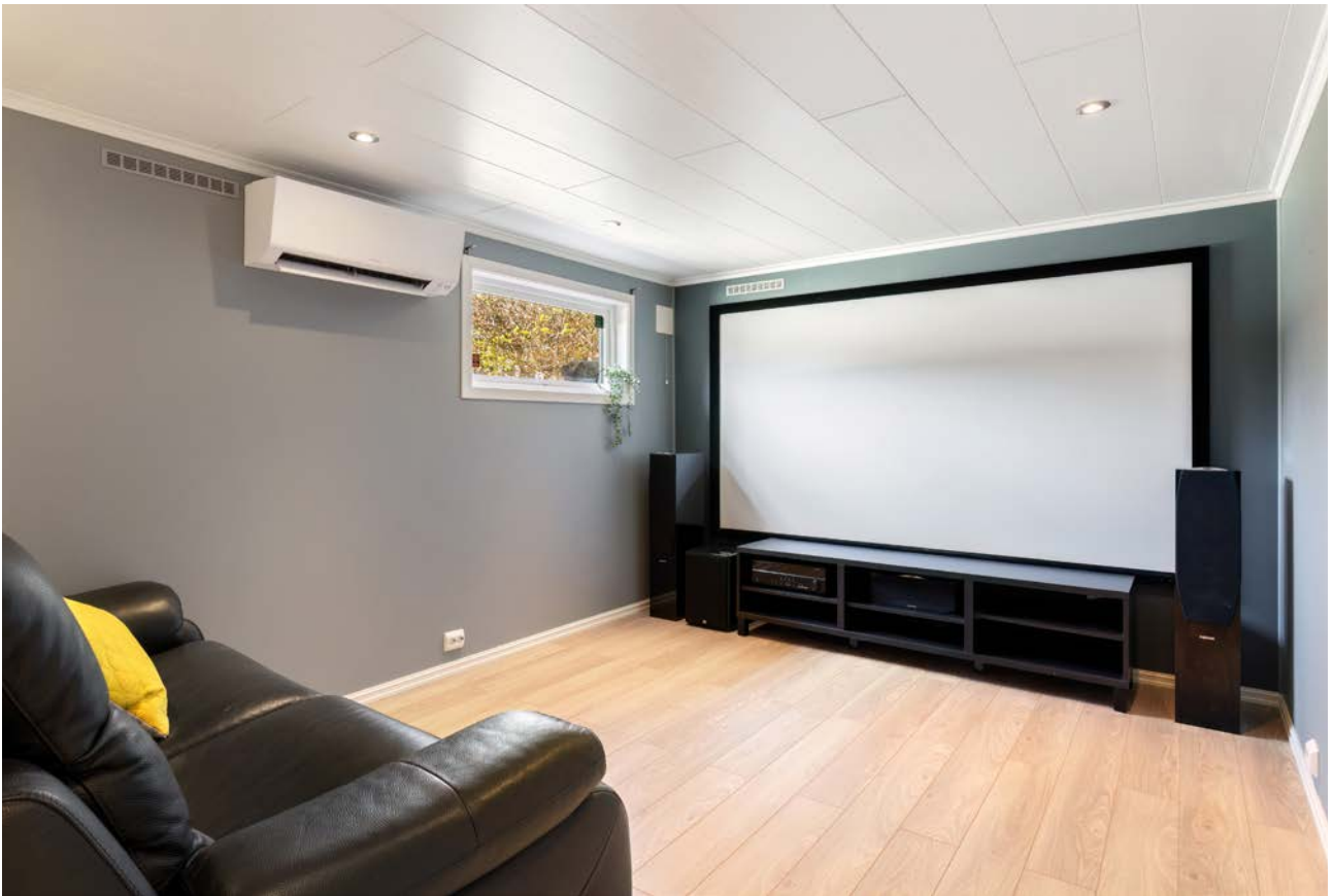
Kjellerstue - varmepumpe installert
