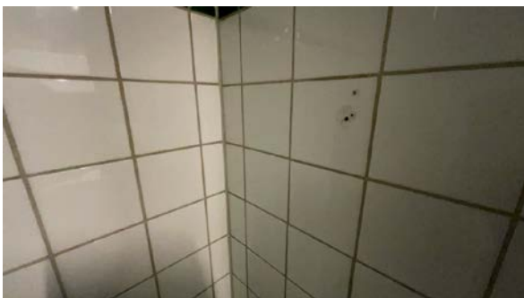
Synlige skruer hull på vegger.
