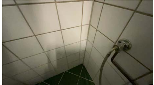
Synlige skruer hull på vegger.
