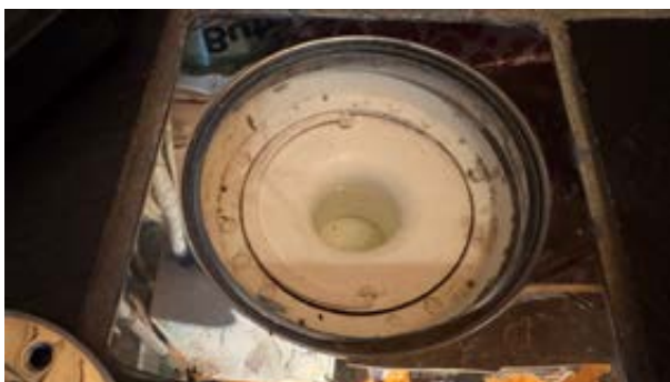
Klemring mangler i sluk og ingen synlig membran.
