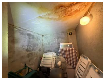
Saltutslag på vegg.
