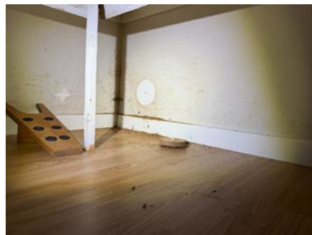
Misfarging på vegg.
