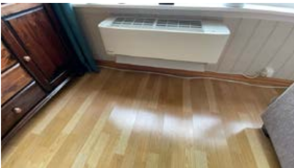
Varmepumpe på stue.
