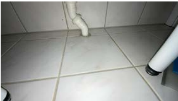
Ingen synlig bruk av rørmansjetter.
