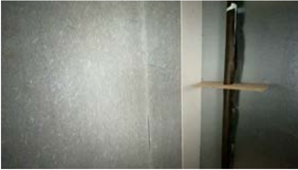
Opprinnelig brannskille med kledning av fibersement/asbestholdige bygningsplater.
