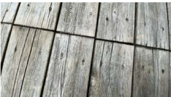
Sprekker/slitasje i terrassebord.
