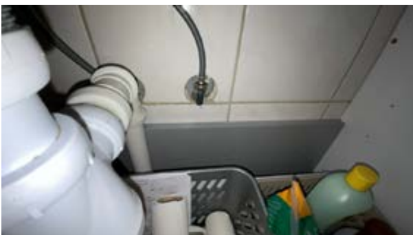
Ingen synlig bruk av rørmansjetter/fuging.
