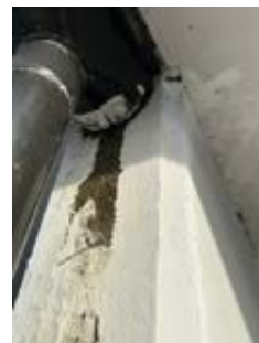
Lekkasje takrenne, maling flasser av
