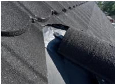
Tidligere lekkasje ved gradrenner som har blitt tettet. Ikke fuktig i dette område i kaldloftet på befaringsdagen.
